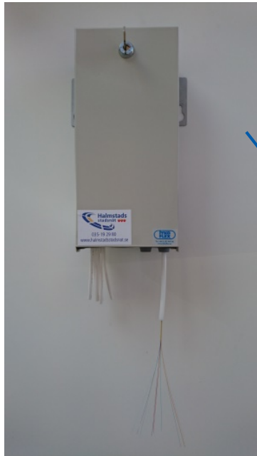
Skarvbox placeras på central plats inne i huset
